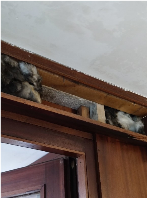
Abbildung 15: Sturzbereich Loggiaverbau, RfM Architektur
