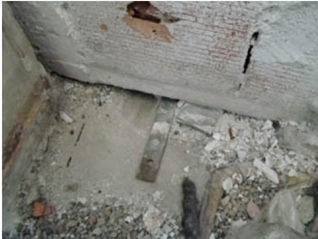
Abbildung 81: Detailaufnahme Montagelasche der vorgehängten Fertigteilplatte Befestigung nicht mehr kraftschlüssig“, (Holler_GmbH, 2012)
