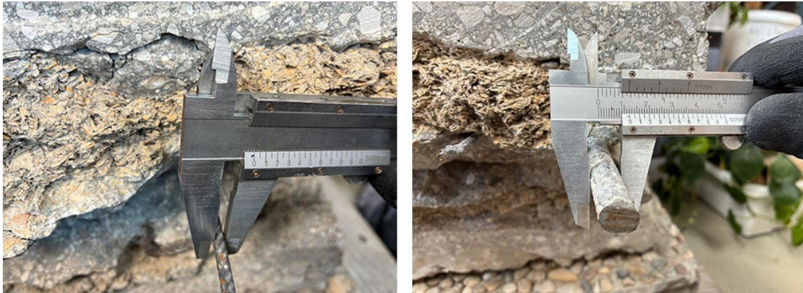
Abbildung 88: Stahlstäbe gefunden bei Fassadenplatten Marktgasse, TU Wien
